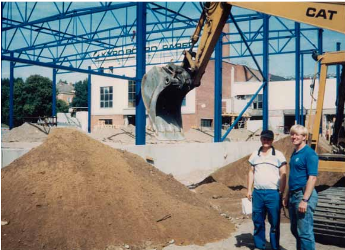
Ari ja Tero Kyröskoskella paperitehtaan laajennustyömaalla. Tämän vaiheen jälkeen oli vuorossa uuden sahan rakentaminen. Kyröskoskella vietettiin kaikkiaan yli kaksi vuotta ja näiden töiden avulla yritys selvisi 90-luvun lamasta.
