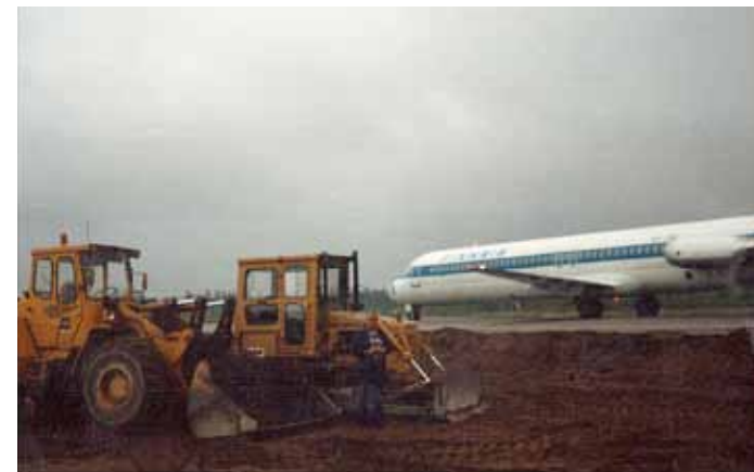
Tässä ollaan edelleen Pirkkalan lentokentän laajennustyömaalla. Tuskin tänä päivänä enää pääsisi noin lähelle käytössä olevaa kiitorataa. Tosin työkonneissa oli radiopuhelimet, joiden avulla lennonjohto antoi tarvittavia ohjeita, milloin oli pysähdyttävä tai väistettävä.
