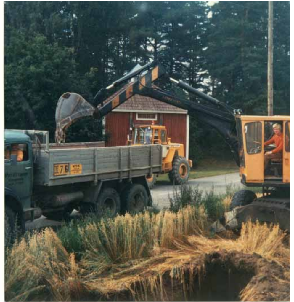
Mersu, Volvo 846 ja Lokomo 320 yhdellä monista Kangasalan kunnalle tehdyistä vesihuoltotyömaista joskus 80-luvun alussa. Ari on Lokomon ohjaimissa.
