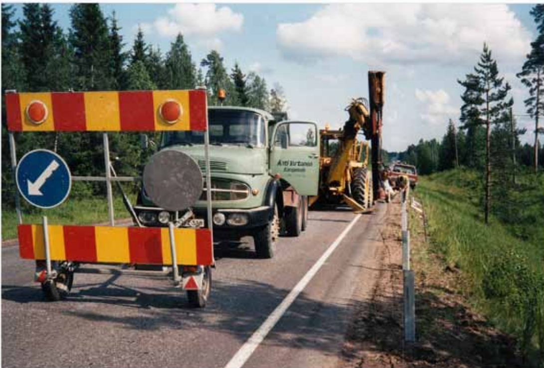
Timo oli Ahdin kanssa tekemässä tiekaiteita Ikaalisten ja Hämeenkyrön alueella vuonna 1995. Kaidekone oli Ahti Virtasen itsensä tekemä. Siinä oli liukupalkkiin asennettu Roxonin vasara ja peruskoneena oli Volvo BM 646.
